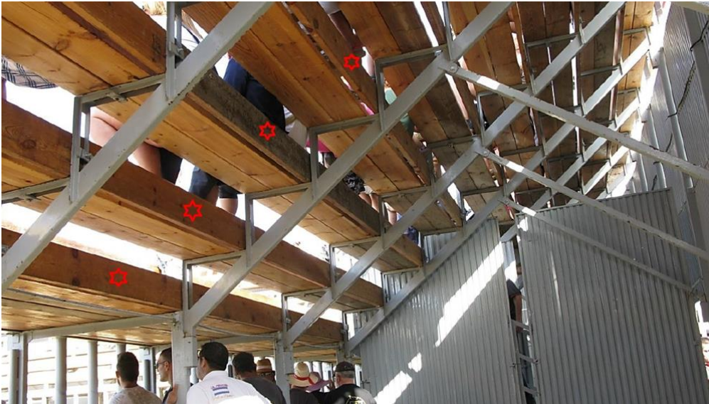
Fig nº 1 Graderío con tableros en "tabicas" (con asterisco), reduciendo el hueco entre tableros de asiento.
