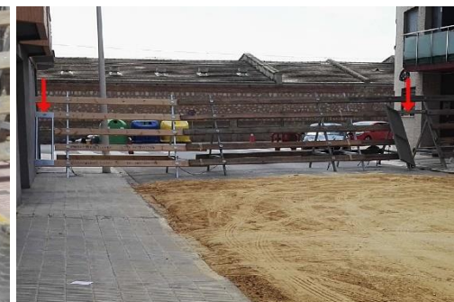
Cierre de BT con paso vertical y puerta.
