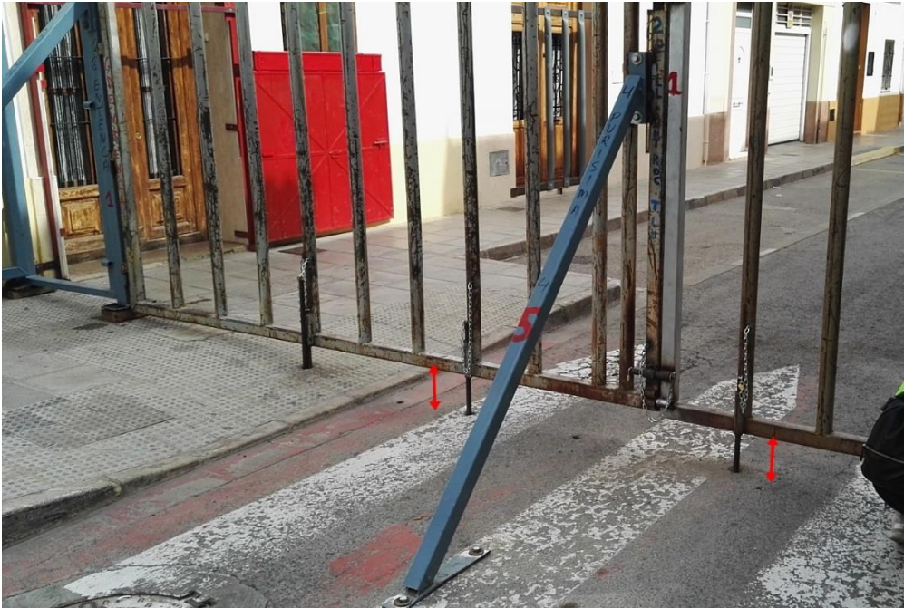
Travesaño inferior elevado más de 10 cm respecto al pavimento, en barrera vertical.
