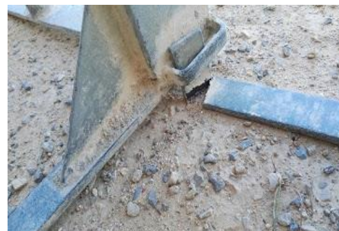
Rotura de elementos tras impacto.
