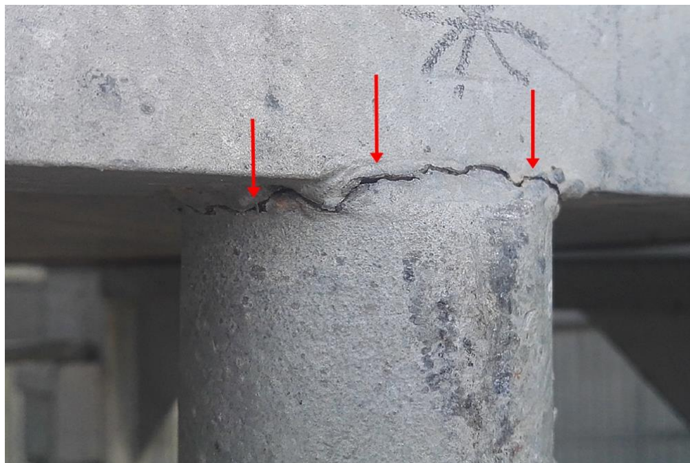
La fisuración en soldaduras es la principal patología de la estructura de las Barreras Verticales.
